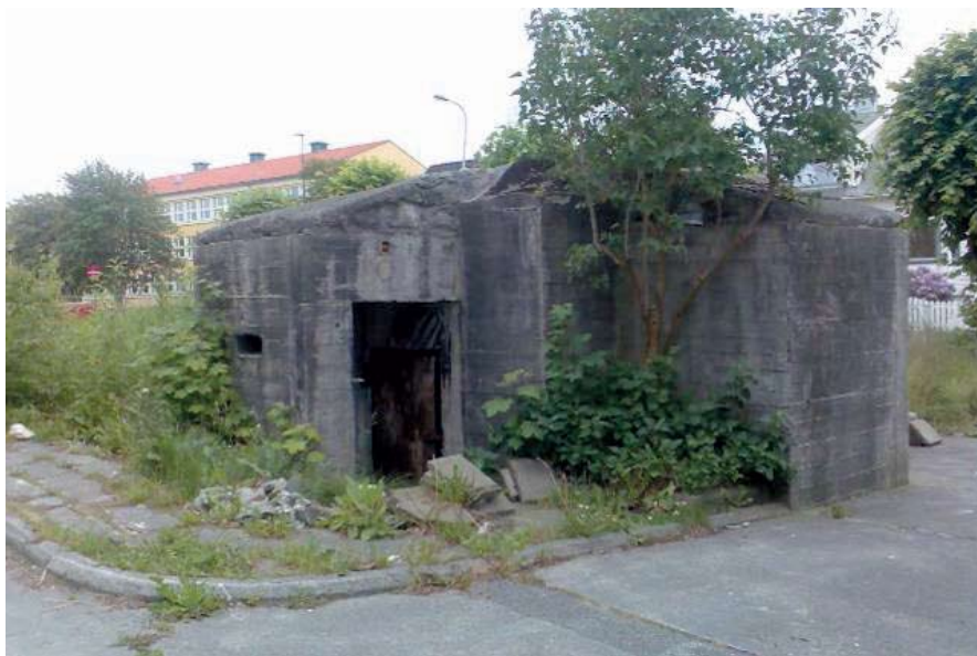
Bunkeren i Bergsagelveien slik den så ut i juni 2007. Kvaleberg skole i bakgrunnen. Foto: Jan Gjerde.
